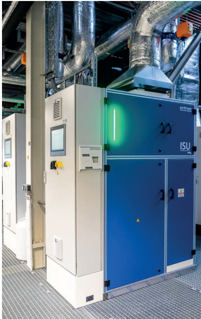
Abbildung 3: Stationäre H 2 O 2 -Anlage zur Dekontamination der Produktionsräume der Drug Substance.
